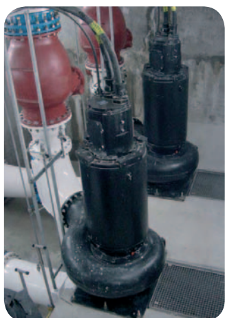
Pompes submersibles dénoyées en fosse sèche
