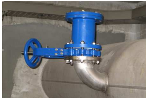
Clapet d'entrée d'air
